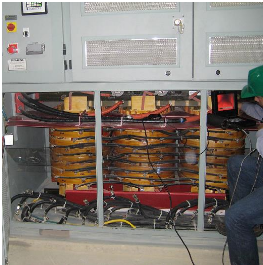
Inspección por limpieza de un transformador Siemens
